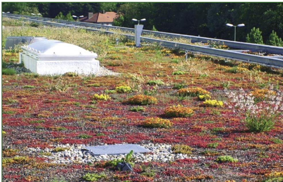
Fot. 17. Roślinność na dachu z nieodpowiednio skomponowanym substratem, Zurych [autor: M. Mioduszewska].
